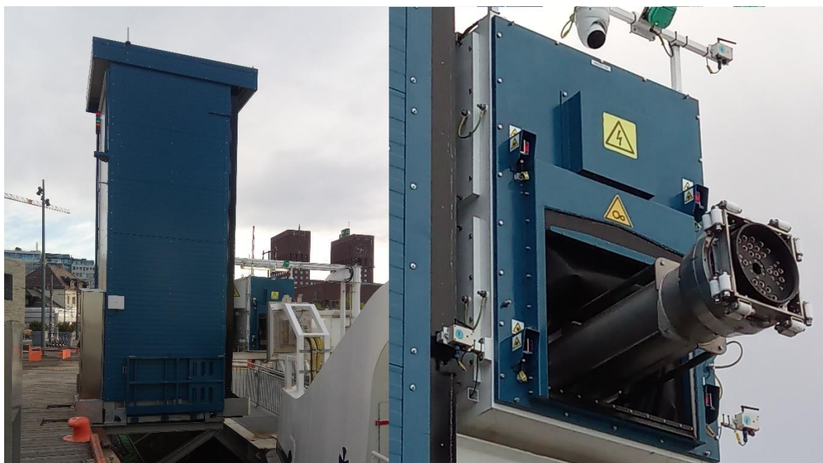
Figur 9 Ladetårn for Nesoddbåtene på Aker brygge i Oslo som ble satt i drift sommeren 2020. Bilde til høyre viser ladeplugg med kontaktpinner for strømoverføring.
