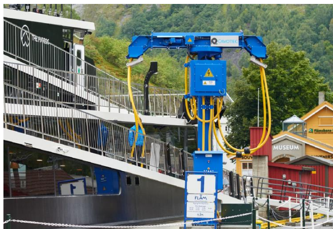
Figur 8 Ladetårn med kabellading til Future of the Fjords i Flåm (Kilde Cavotec)
