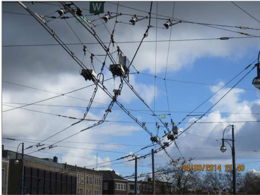
Figur 21. Kontaktledningsanlegg kan være dyrt å kjøpe.
